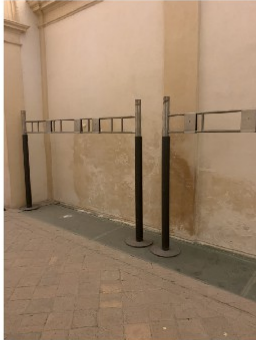
Risalite di umidità
