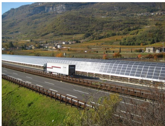
Figura 8: Installazione di barriere acustiche munite di moduli fotovoltaici lungo l'autostrada A22 "del Brennero" [19]
